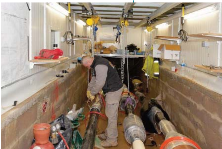
Chambre de jonction
